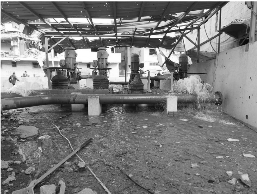
دمار واسع في خزان المياه بمنطقة تل الهوى جنوب غرب مدينة غزة بفعل قصف إسرائيلي للمنطقة، المصدر: بلدية غزة على موقع التواصل الاجتماعي فيسبوك - 12 مايو 2024
